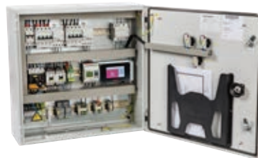
Schaltschrank mit HWAT-ECO v5 eingebaut
